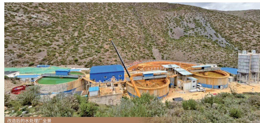
改造后的水处理厂全景
